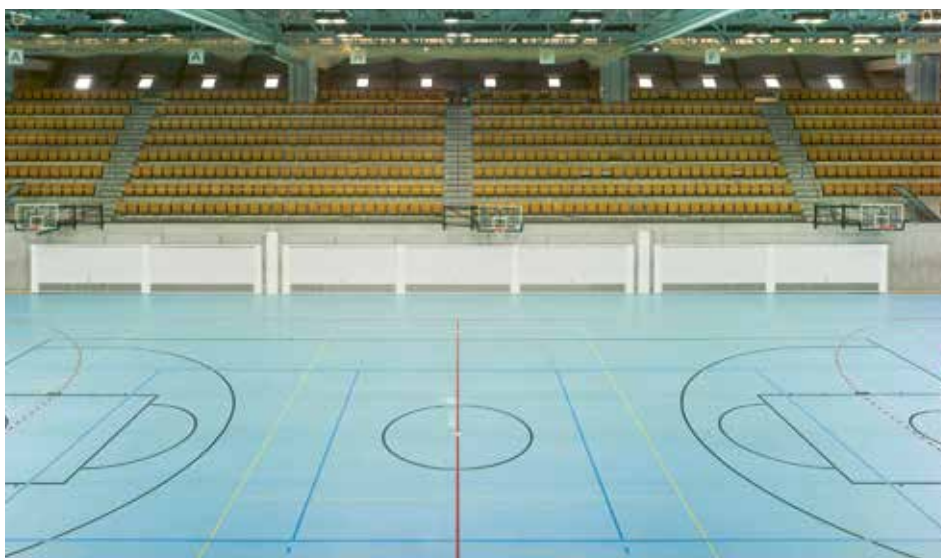
Abbildung 6.16: Die bestehende Hallenbeleuchtung wurde teilweise auf LED-Scheinwerfer umgerüstet. (Foto: Stadt Bern)
