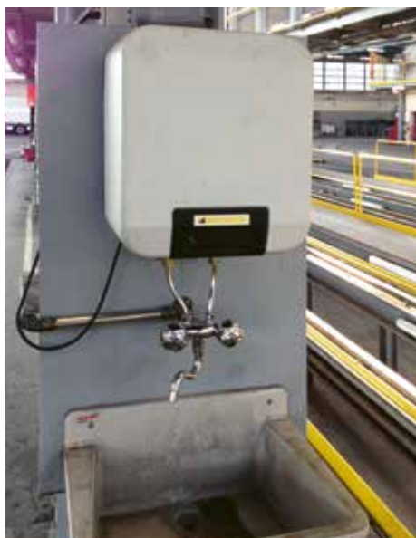
Abbildung 3.14: Manchmal die bessere Lösung: ein dezentraler Wassererwärmer. Projekt VBZ Tramdepot Zürich-Oerlikon.
