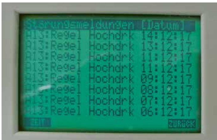
Abbildung 6.5: Störungsmeldungen der Grundwasser-Wärmepumpe. (Foto: Böhler, MTU GmbH)
