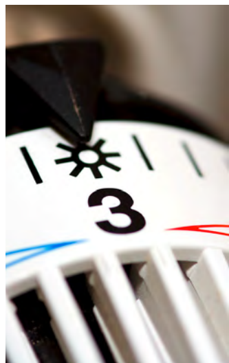
Thermostatventile regeln den Durchfluss des warmen Heizwassers durch die Heizkörper und passen die Leistung der Heizungsanlage dem Bedarf an.
