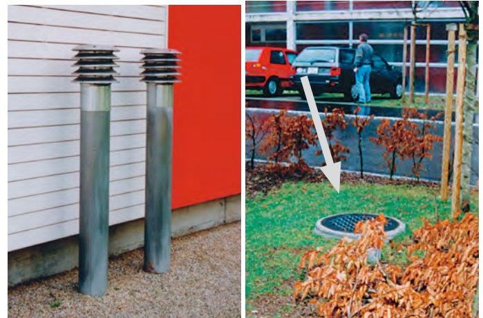
Ein gutes (links) und ein schlechtes Beispiel (rechts) für eine Aussenluftfassung. Ist die Fassung ebenerdig angebracht, können Staub, Blätter und andere Immissionen die Anlage verschmutzen.
