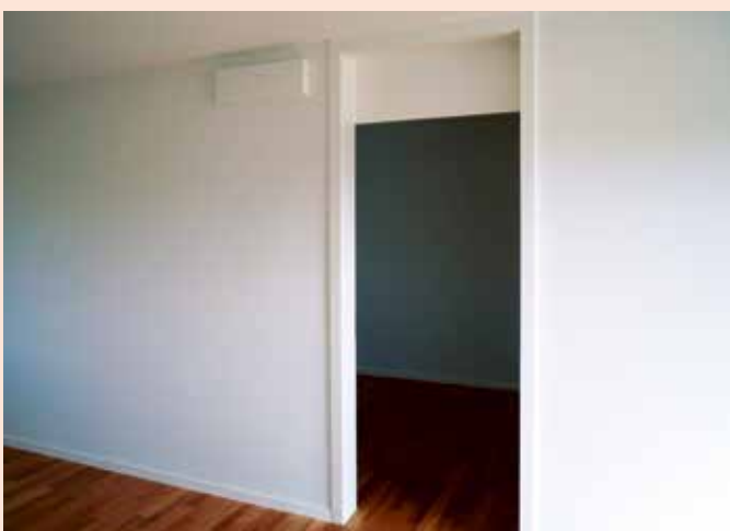
Bild 3.8: Der Verbundlüfter links oberhalb der Tür fördert Luft aus dem Wohnzimmer ins Schlafzimmer.
