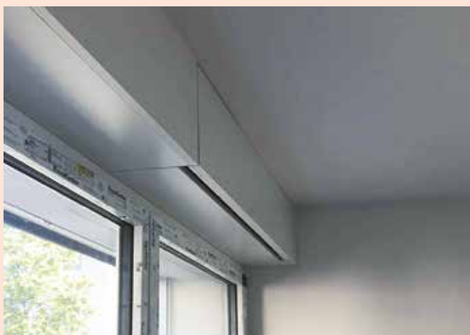
Bild 3.16: Die Einzelraumlüftungsgeräte liessen sich ohne grösseren Aufwand in den Rahmenverbreiterungen der Fenster unterbringen. (Quelle: Ventoswiss AG)
