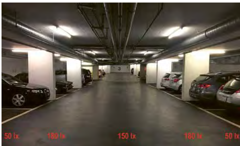
Abbildung 6.19: Die Beleuchtung und die gemessene Beleuchtungsstärke vor der Erneuerung.
