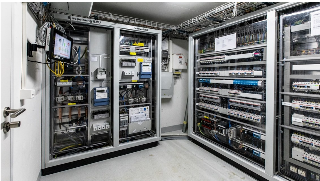
Abbildung 43: MFH in Wetzikon AG, Technikraum mit EMS und Zähler für ZEV-Abrechnung (Quelle: Arento AG)
