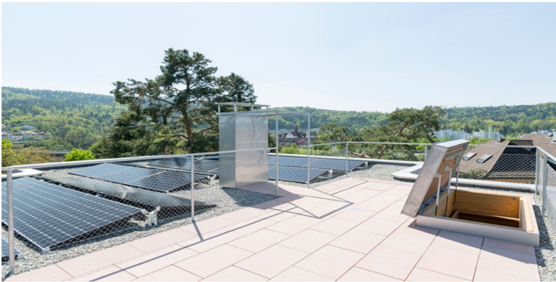
Abbildung 37: MFH in Wettingen AG, PV-Anlage auf Dach (Ost-West) (Quelle: Hürzeler Architekten AG)
